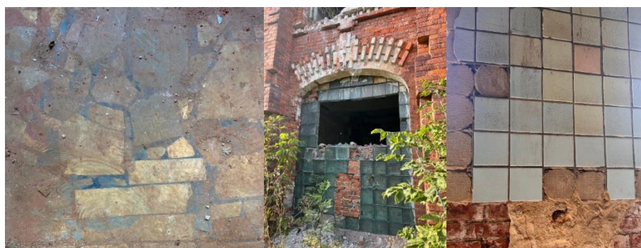
Рисунок 6 — Сохранившиеся фрагменты напольного покрытия печатного корпуса, стеклоблоки в оконных проемах, голубая облицовочная керамическая плитка, осень, 2023 г. (фото Е. А. Ефимовой)
